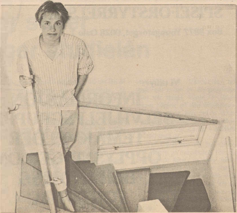
Trappa er mildest talt farlig. Gerd viser her ett av de løse trappegelenderne.
